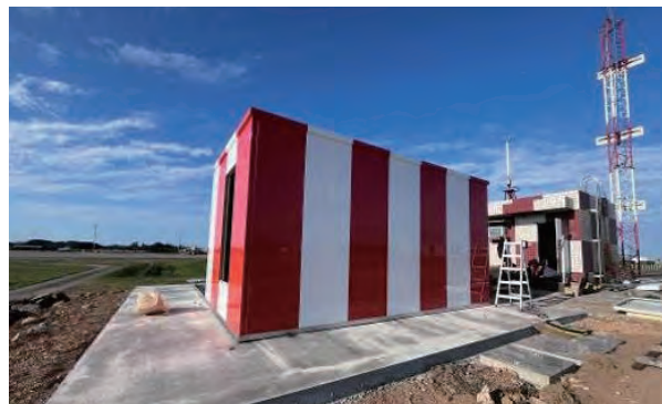
桃園機場 23R GP 新設機房
