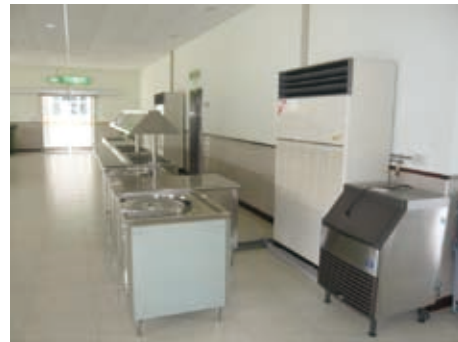
北部飛航服務園餐廳廚房設備
