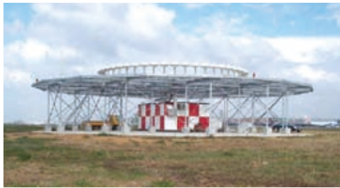
都卜勒特高頻多向導航臺(DVOR)
