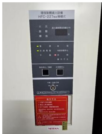
環保氣體滅火設備
