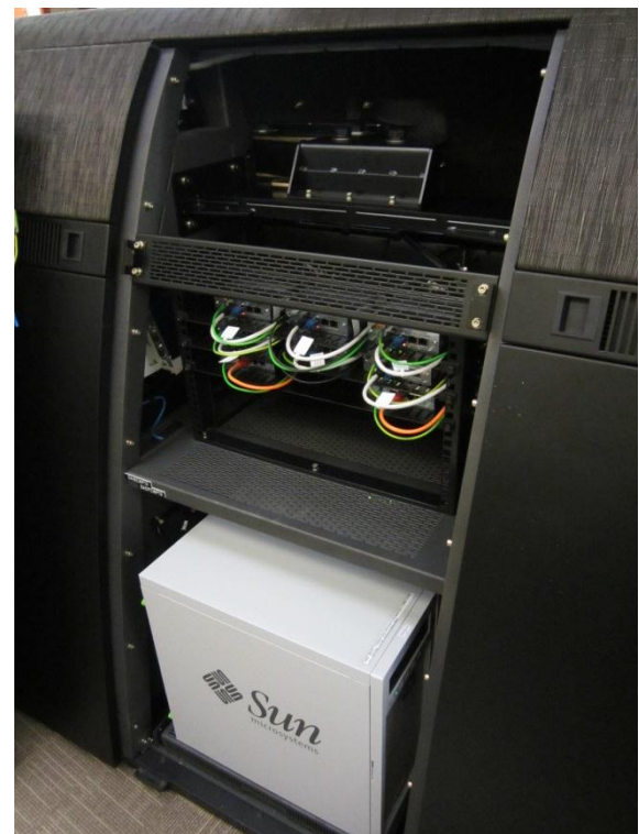
▲ CWP 主機及線路機櫃
